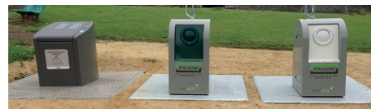
Le conteneur collectif et les deux bulles à verre enterrés de l'Avenue des Robiniers
